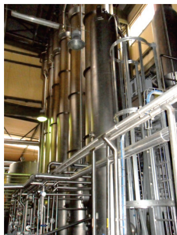
Rys. 17. Kolumny 3, 4, 5 urządzenia wyparnego służące do zagęszczania soku
