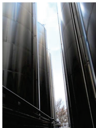
Rys. 4. Zewnętrzne zbiorniki magazynowe dużej pojemności
