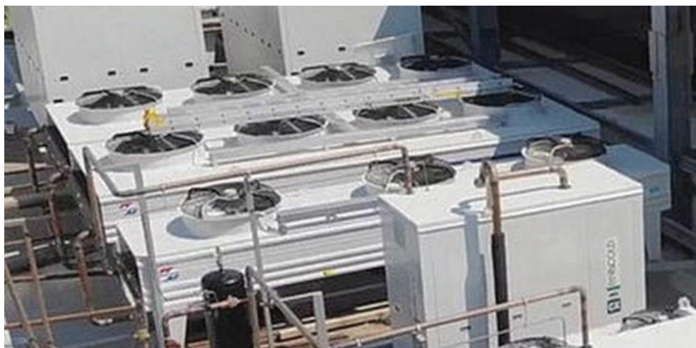
Rys. 38. Widok skraplaczy chłodzonych powietrzem ( incools.com/en/article/article-41 )
