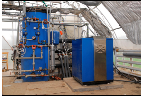
Rys. 3.10. Stanowisko laboratoryjne w tunelu pokrytym poliwęglanem wyposażone w pompę ciepła współpracującą z pionowymi i poziomymi wymiennikami ciepła oraz ze zbiornikiem akumulującym ciepło pochodzące z kolektorów słonecznych
