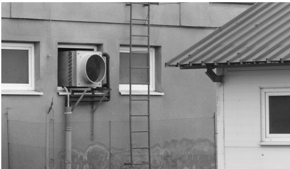
Rysunek 3.5. Klimakonwektor pełni dwie funkcje – wentylacja pomieszczenia inwentarskiego i odzysk ciepła ze zużytego powietrza (Foto: R.Szulc)
