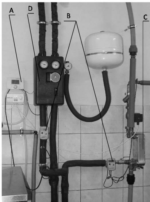
Rysunek 3.16. Instalacja kontrolno-pomiarowa A – mikrokomputer, B – ciepłomierze, C – wymiennik płytowy, D – grupa pompowa (Foto: R. Szulc)
