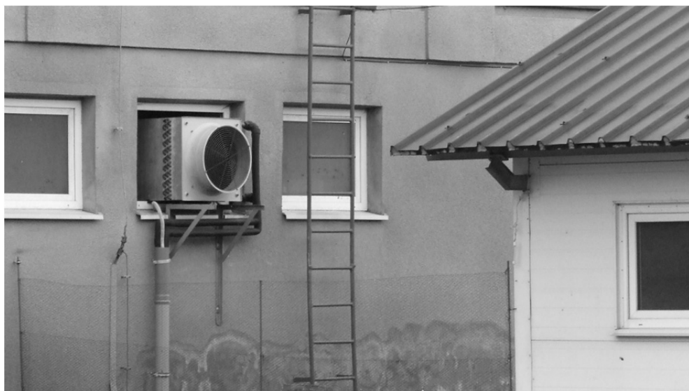
Rysunek 3.5. Klimakonwektor pełni dwie funkcje – wentylacja pomieszczenia inwentarskiego i odzysk ciepła ze zużytego powietrza (Foto: R. Szulc)
