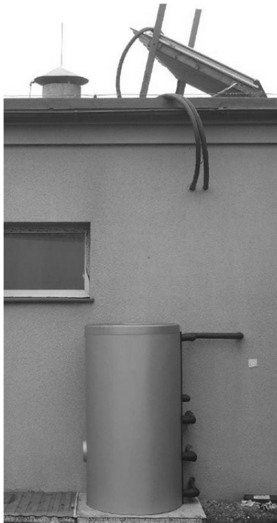
Rysunek 3.15. Wymiennik ciepła z kolektorem słonecznym zainstalowany na dachu hali udojowej w ITP Odział w Poznaniu
