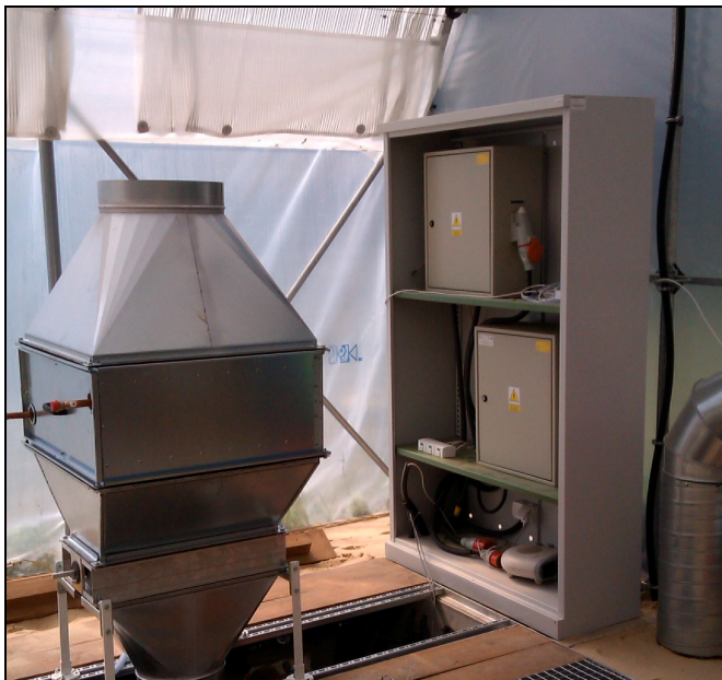
Fot. 9. Wymiennik ciecz – powietrze do magazynowania ciepła w akumulatorze wodnym
