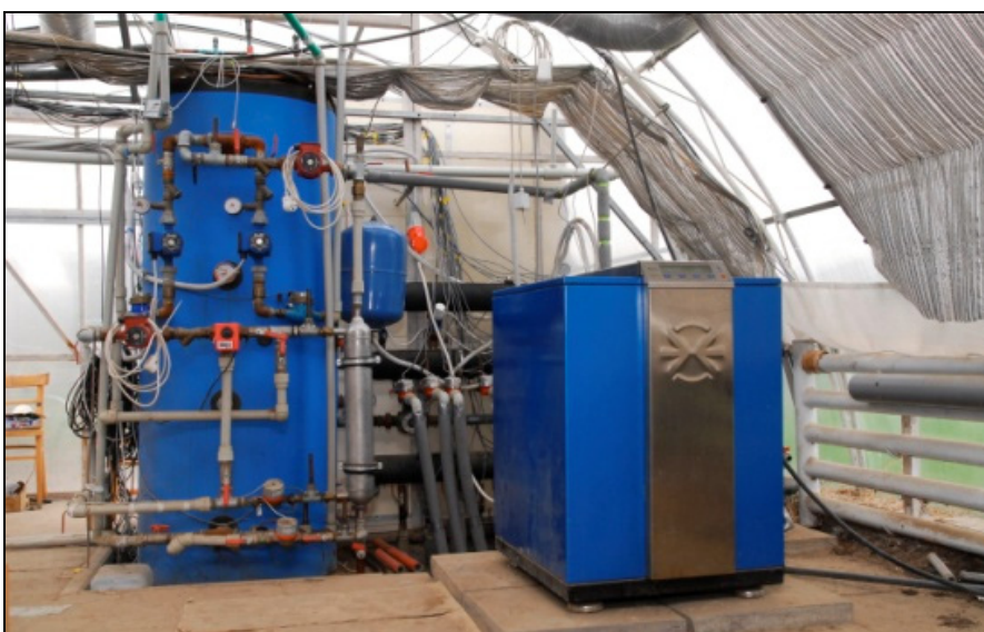
Fot. 5. Pompa ciepła w laboratorium z wykorzystania urządzeń energetyki odnawialnej w obiekcie ogrodnictw
