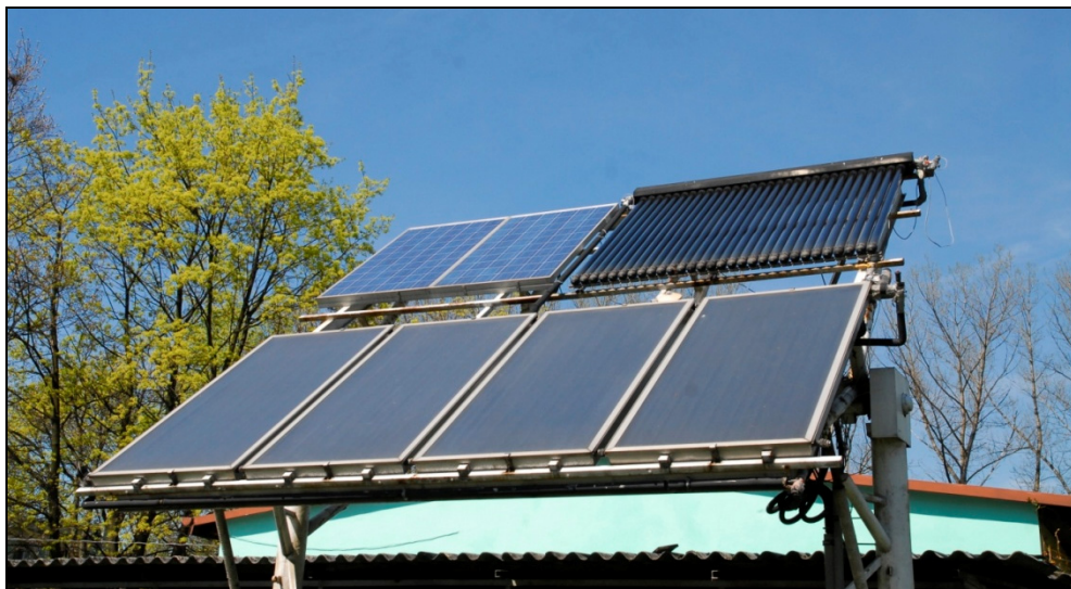
Fot. 6. Urządzenia energetyki odnawialnej (płaskie i próżniowy kolektor słoneczny, panel fotowoltaiczny)
